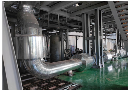
主泵试验回路
